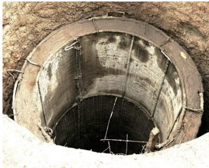
„Unsere“ Brunnen sind mit Stahlbeton ausgekleidet, sicher, nachhaltig
